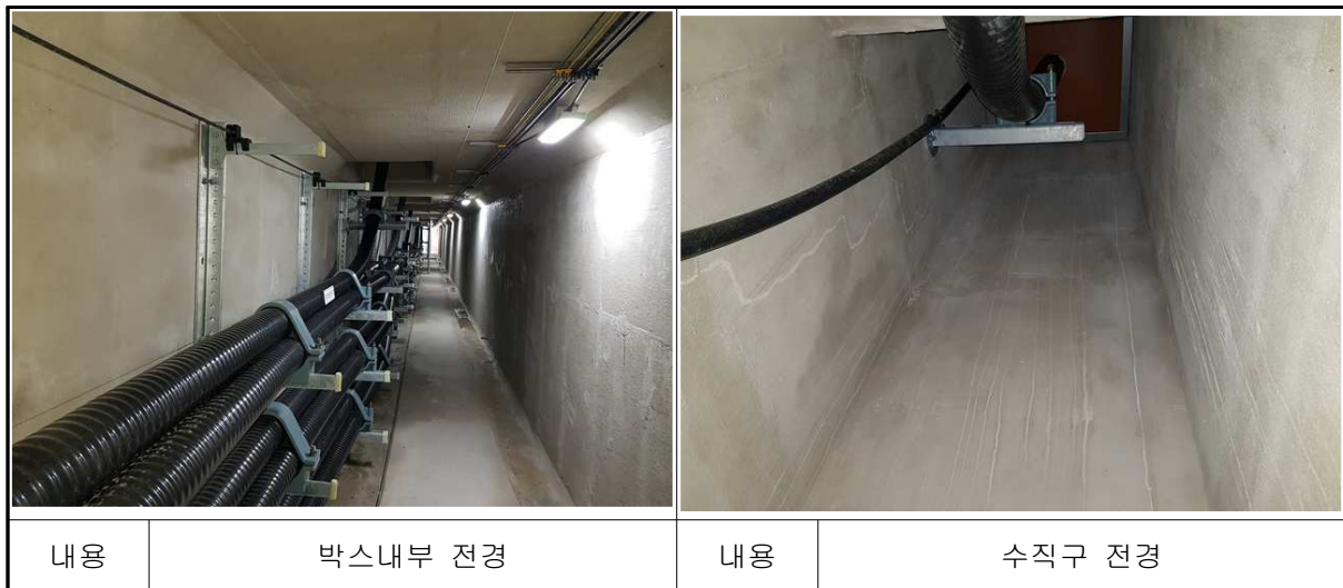
【사진 2.1】 포천인출 전력구 현황
